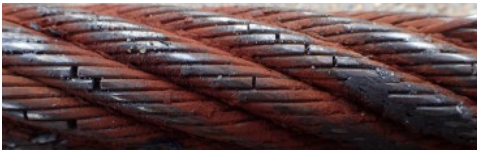
Abb. 80 - Reibkorrosion („Fretting Corrosion“) infolge von Kontakt zwischen Litzen
